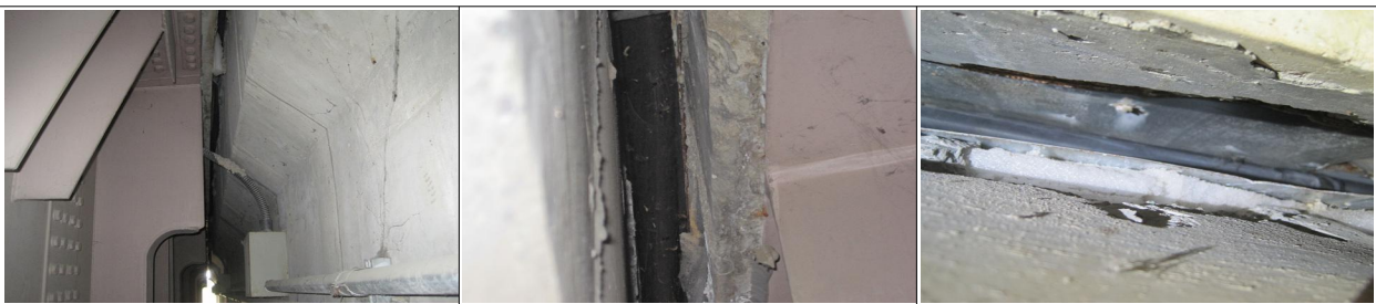
③ 신축이음 A2 하부 누수-주기적인 점검을 통한 손상진전여부 확인
